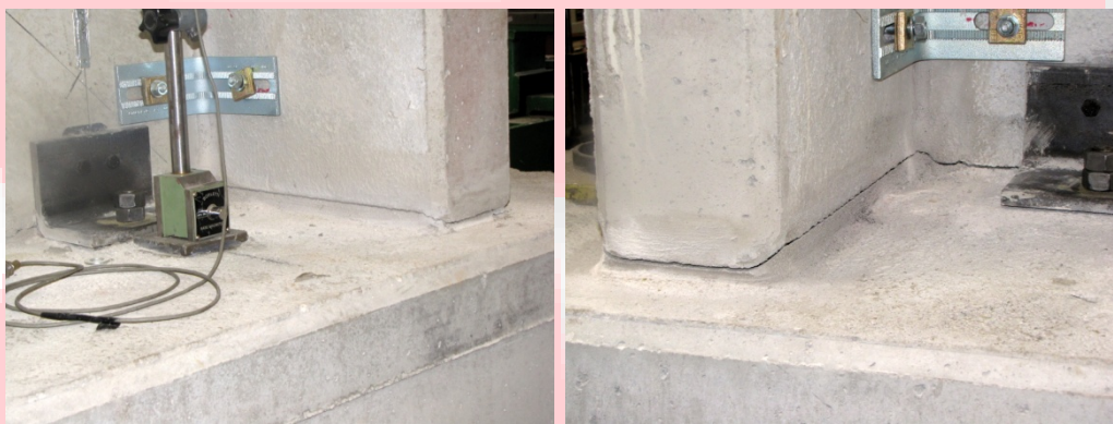
Figura 7: prova 2 - fessura fra il basamento ed i pannelli del piano terra
